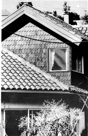
Unión cubierta de teja con paramento vertical en tejas de alero. Vivienda en Lomas de San Andrés, Concepción.
