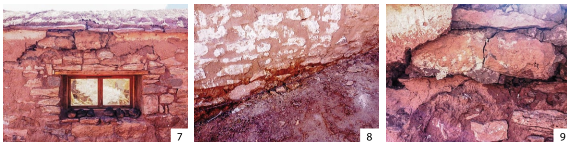
Figura 7 erosión por humedad en la base del muro. Fuente S. Alfaro, junio 2014/ Figura 8 desprendimiento total revoque en muro del Evangelio y evidencia de grietas pasantes en torno al vano. Fuente S. Alfaro, junio 2014/ Figura 9 grieta en unidad lítica de mampostería en muro del Evangelio sobre vano existente. Fuente S. Alfaro, junio 2014
