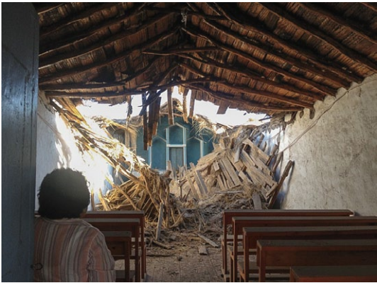
Figura 5 muestra interior colapso de techumbre de la zona central de la nave del templo. Fuente S. Alfaro, marzo 2014
