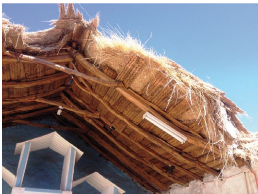
Figura 6 zona de fractura de la estructura de techumbre. Fuente S. Alfaro, junio 2014
