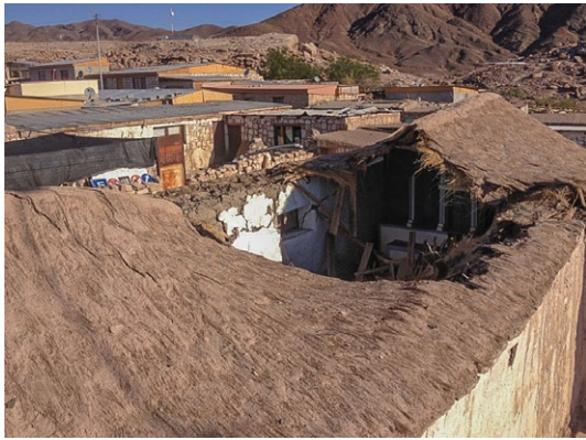
Figura 4 muestra exterior colapso de techumbre de la zona central de la nave del templo. Fuente S. Alfaro, marzo 2014
