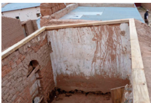
Figura 7 Colocación de viga de encadenado superior de madera. Fuente: Fotografía de las autoras.
