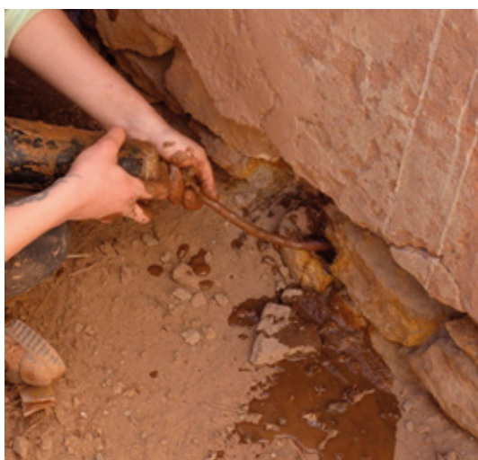
Figura 6 Inyección de mortero de barro en sobrecimientos. Fuente: Fotografía de las autoras.
