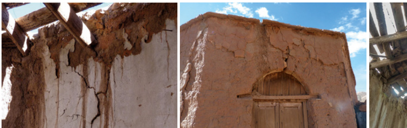
Figura 5 Imágenes de algunas de las patologías constructivas detectadas. Fuente: Fotografía de las autoras.
