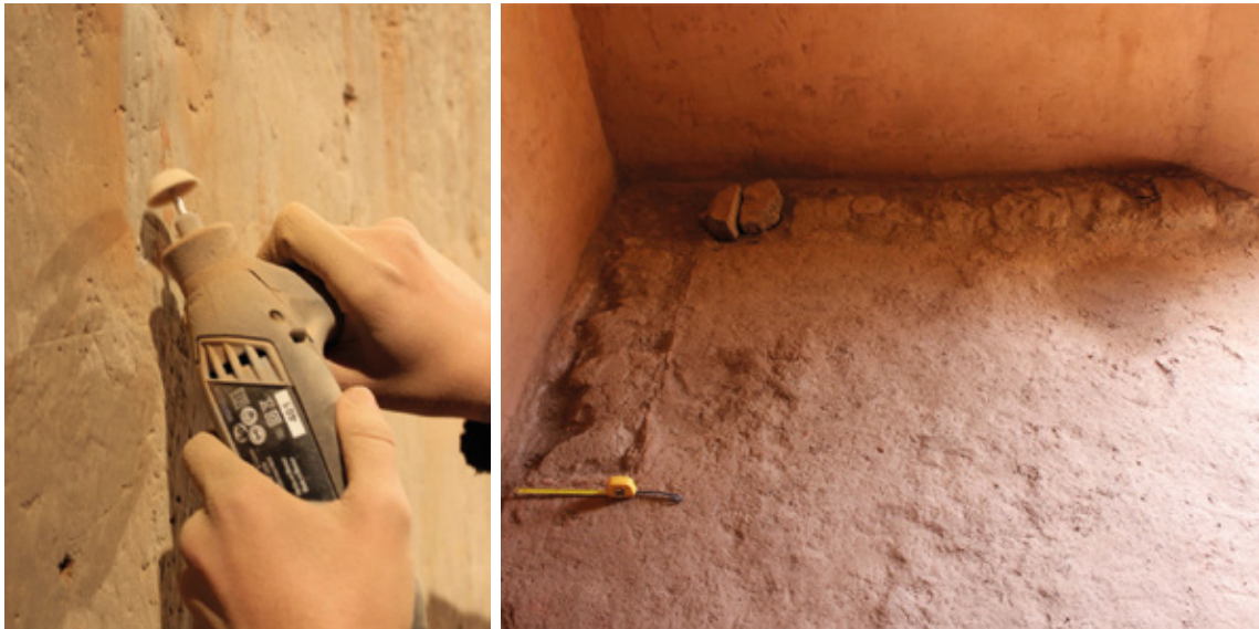
Figura 11 Limpieza de grabados históricos. Fuente: Fotografía de las autoras.
