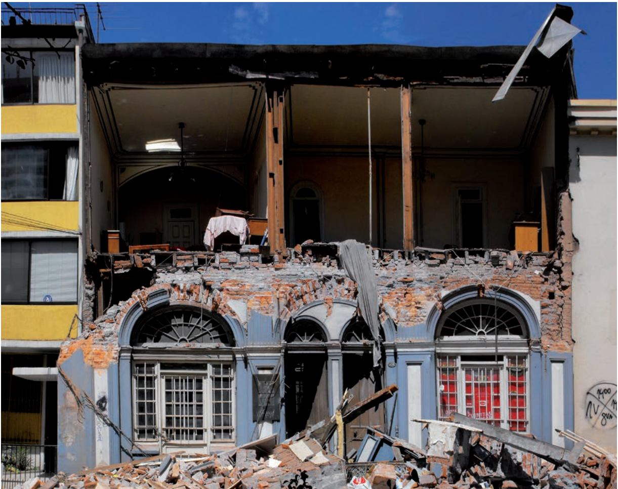
Figura 14a A 10 días del terremoto. Calle San Martín entre Colo Colo and Aníbal Pinto. Antigua vivienda de fachada-continua estructurada a base de ladrillo. / Ten days after the earthquake. San Martín street between Colo-Colo and Aníbal Pinto. Old brick street front house.
