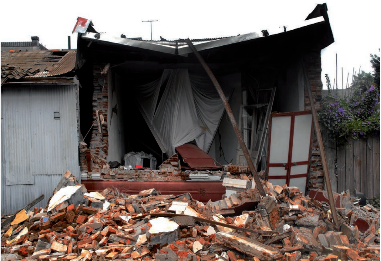
Figura 12 A 12 días del terremoto. Calle Serrano entre Rozas y Cruz. Antigua vivienda de fachada continua estructurada a base de ladrillo. / Twelve days after the earthquake. Serrano street between Rozas and Cruz. Old brick street front building.
