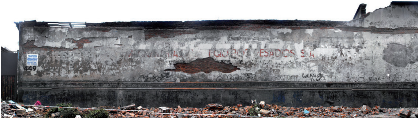
Figura 9a y 9b A 15 días del terremoto. Esquina calles Rengo y Rozas. Antigua edificación de fachada-continua, estructurada a base de ladrillo que albergaba recinto educacional. / Fifteen days after the earthquake. Corner of Rengo and Rozas. Old brick street front building that used to house an educational establishment.
