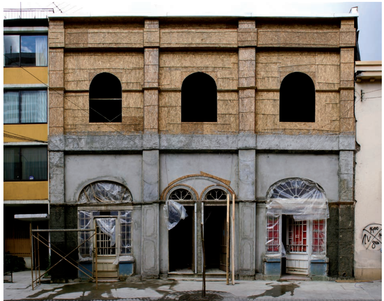
Figura 14b A 5 meses del terremoto. Situación actual. Edificación en proceso de rehabilitación. / Current state of building under repair five months after the earthquake.
