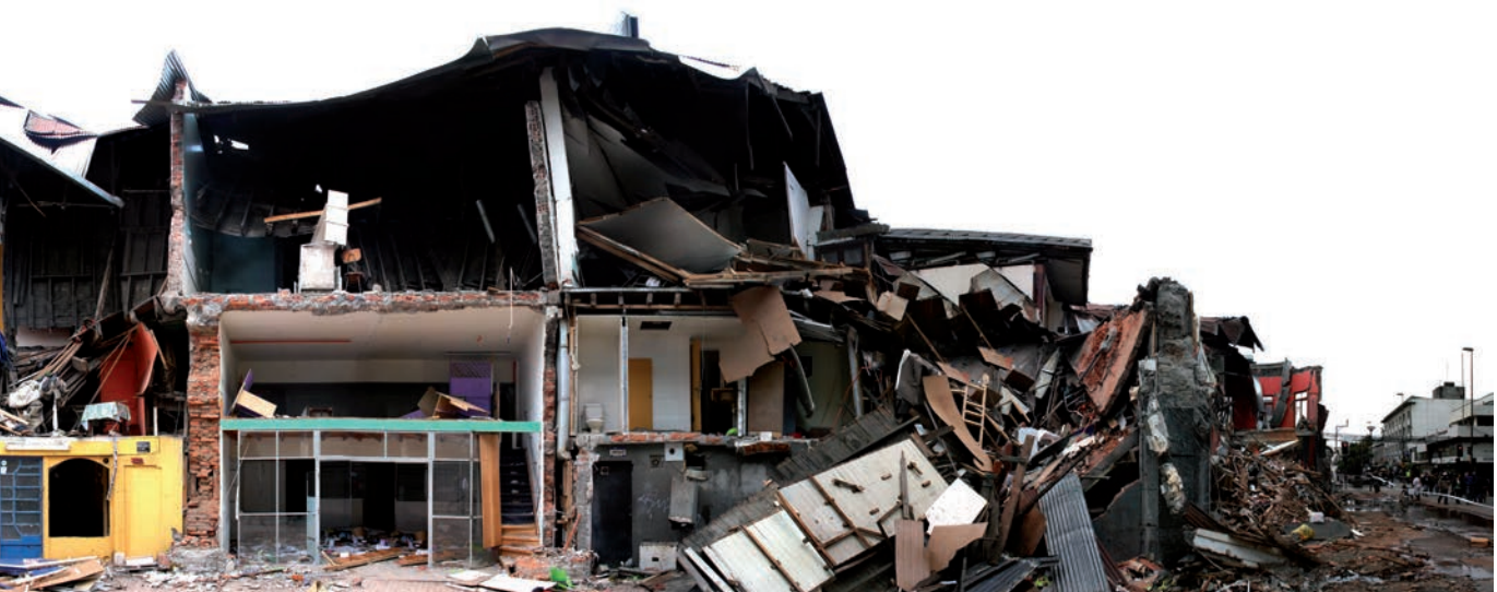
Figura 2 A 10 días del terremoto. Antigua edificación de fachada-continua estructurada en ladrillo que albergaba principalmente recintos comerciales. Pasaje Aurelio Manzano entre Barros Arana y calle Freire. / Ten days after the earthquake. Old brick street front building that used to house mainly commercial dependencies.
