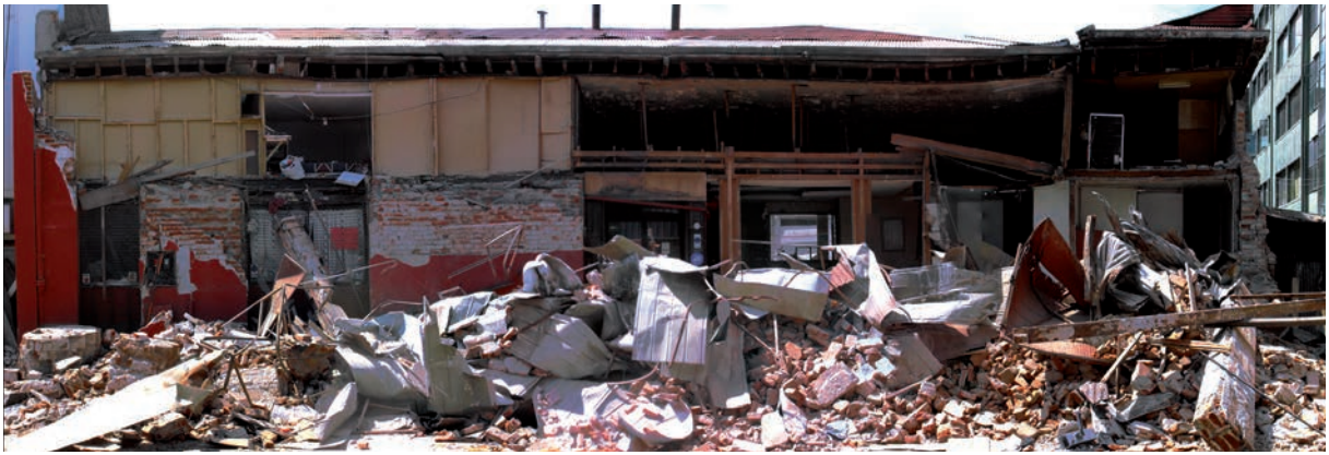
Figura 10 A 18 días del terremoto. Calle Lincoyán entre Barros y Freire, ex restaurant “La Muralla China”. Antigua edificación de fachada continua, estructurada a base de ladrillo. / Eighteen days after the earthquake. Lincoyán street between Barros and Freire, ex ‘Chinesse Wall’ restaurant. Old brick street front building.
