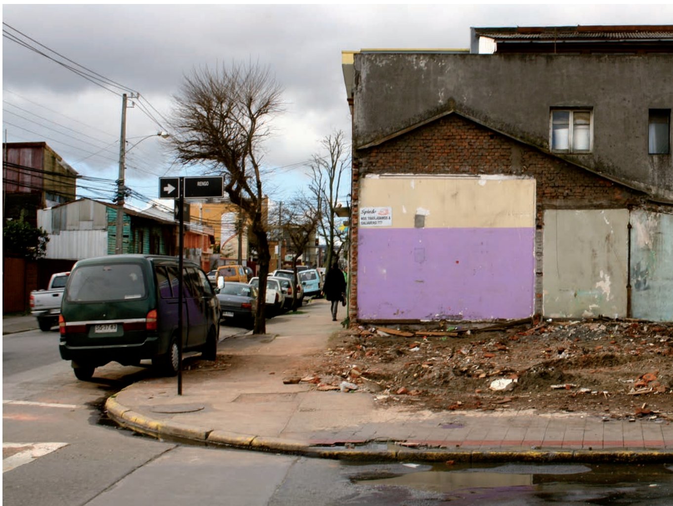
Foto 17 A 5 meses del terremoto. Sitio eriazo luego de la demolición. Esquina calles Cruz y Rengo. / Five months after the earthquake. Empty site after demolition. Corner of Cruz and Rengo.
