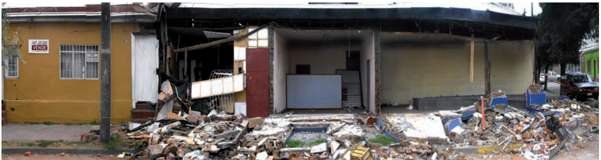
Figura 11 A 10 días del terremoto. Esquina calles Cruz y Rozas. Antigua vivienda de fachada-continua estructurada a base de ladrillo. / Ten days after the earthquake. Corner of Cruz and Rozas. Old brick street front building.
