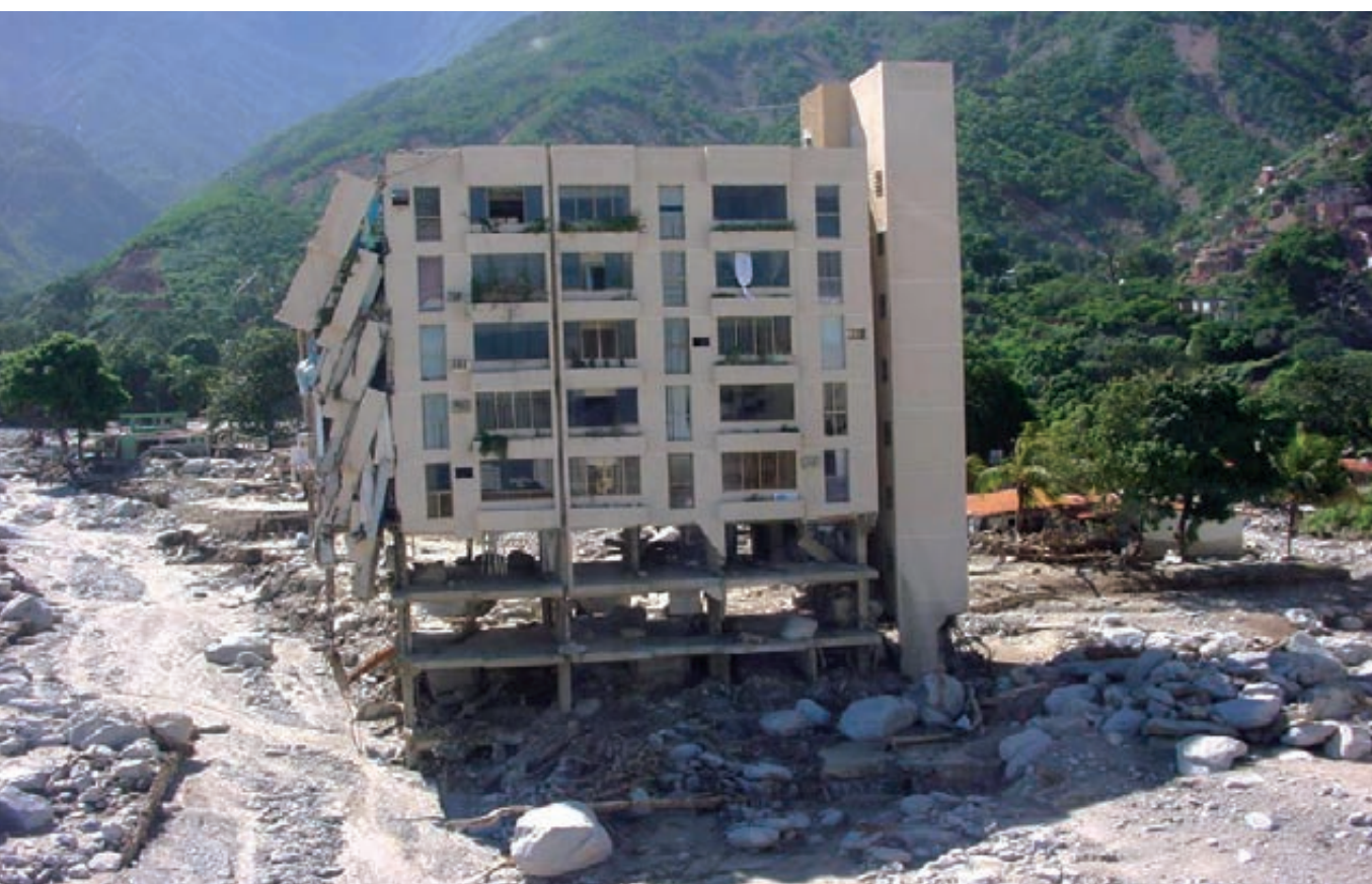
Figura 2 Edificio "Playa Cristal" ubicado en población "Los Corales" en el Estado Vargas, Venezuela. Destruído en el evento hidrológico de diciembre de 1999. ¿Cambio climático o modelo de desarrollo?. Foto: Alejandro Linayo.
