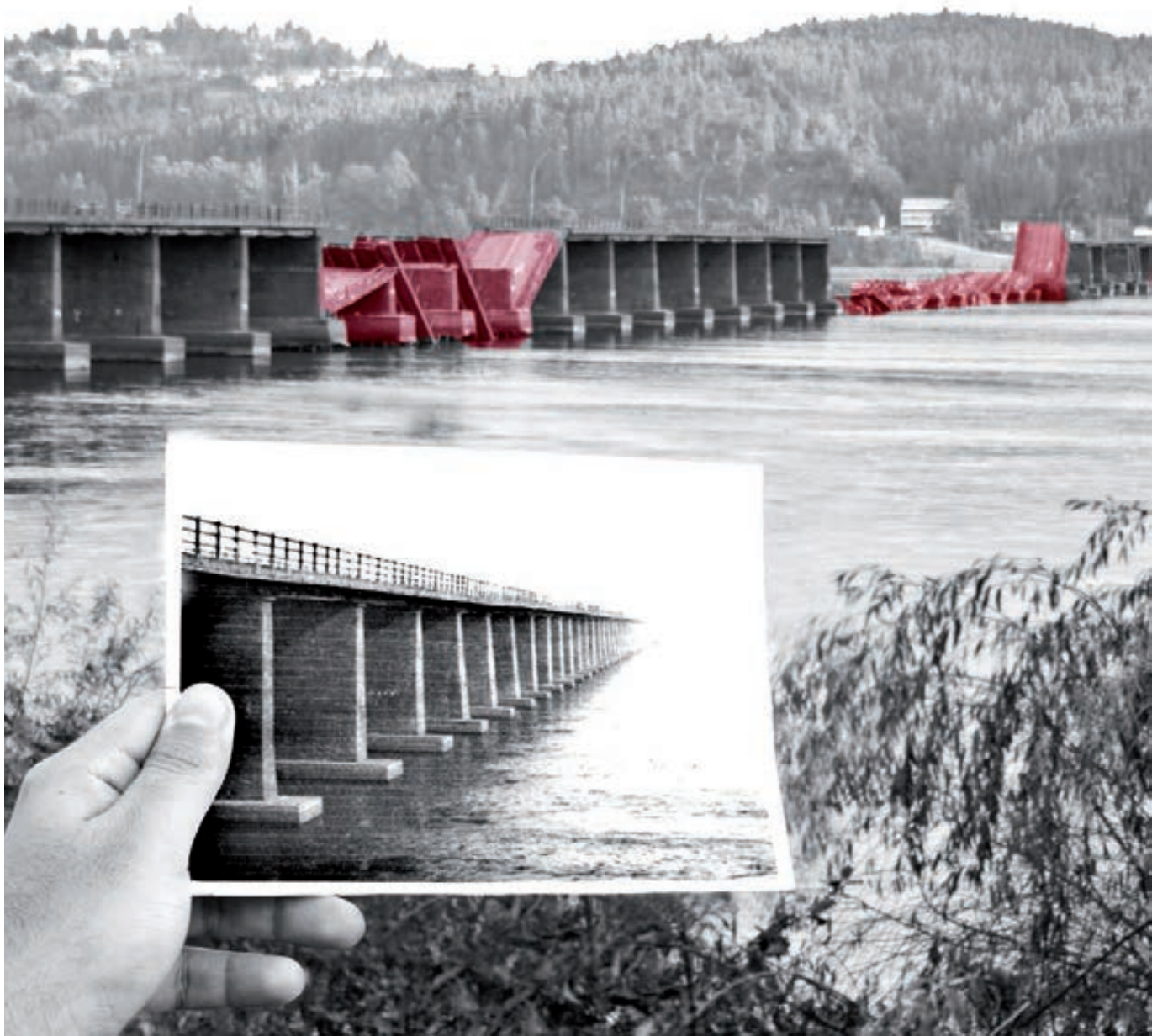
Figura 0 Puente Viejo Bío-bío después del terremoto. Mayo 2010. Foto: Gustavo Burgos.
