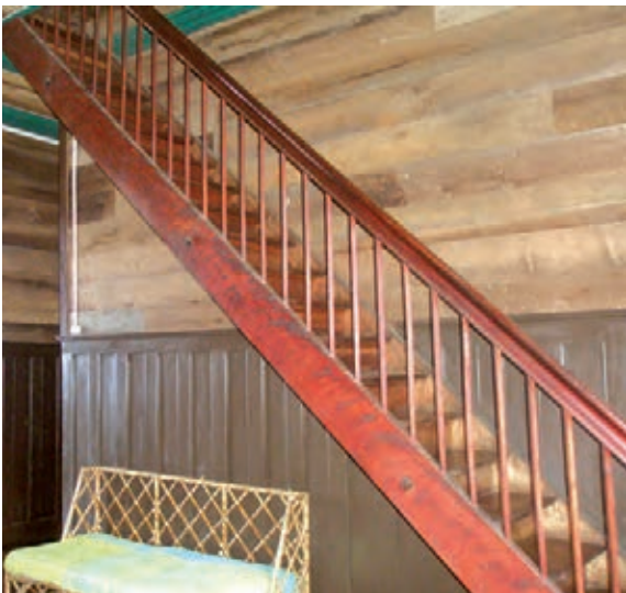
Figura 12 Eliminación de papel mural y arpillera existentes. Raspado del revestimiento de madera de Laurel, zócalo y escalera. Se embuten tuberías del sistema eléctrico en la pared. Foto: Christian Valenzuela.
