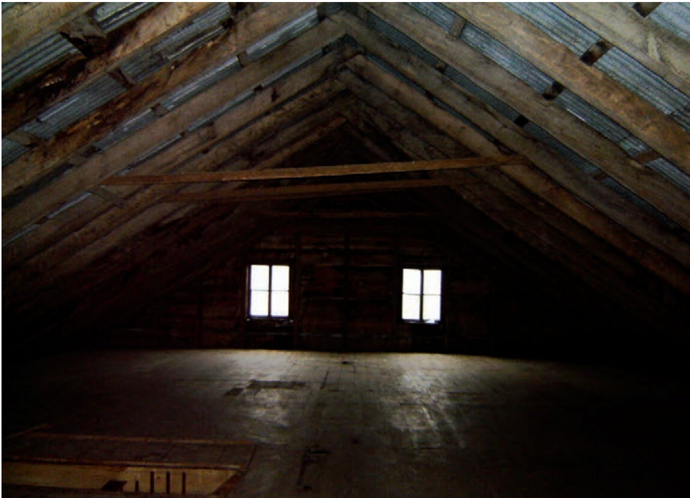
Figura 9 Altillo o soberado sin usar; sin aislaciones, revestimientos ni instalaciones eléctricas. Foto: Christian Valenzuela.
