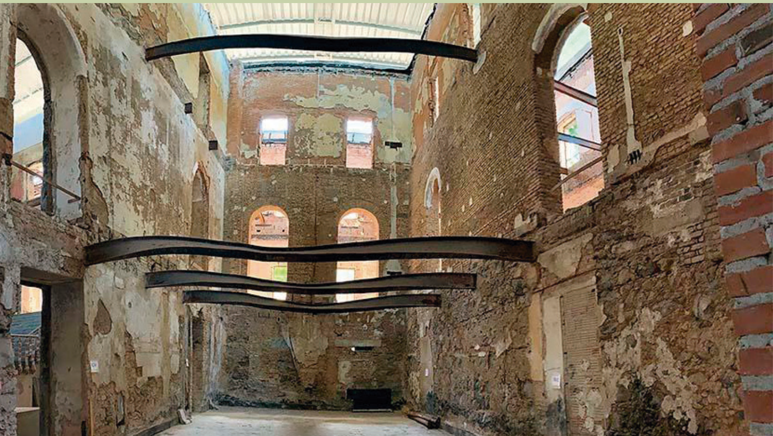
Figura 0. Marcas e cicatrizes do incêndio no Paço de São Cristóvão. Fonte: Acervo do autor, 2021.
