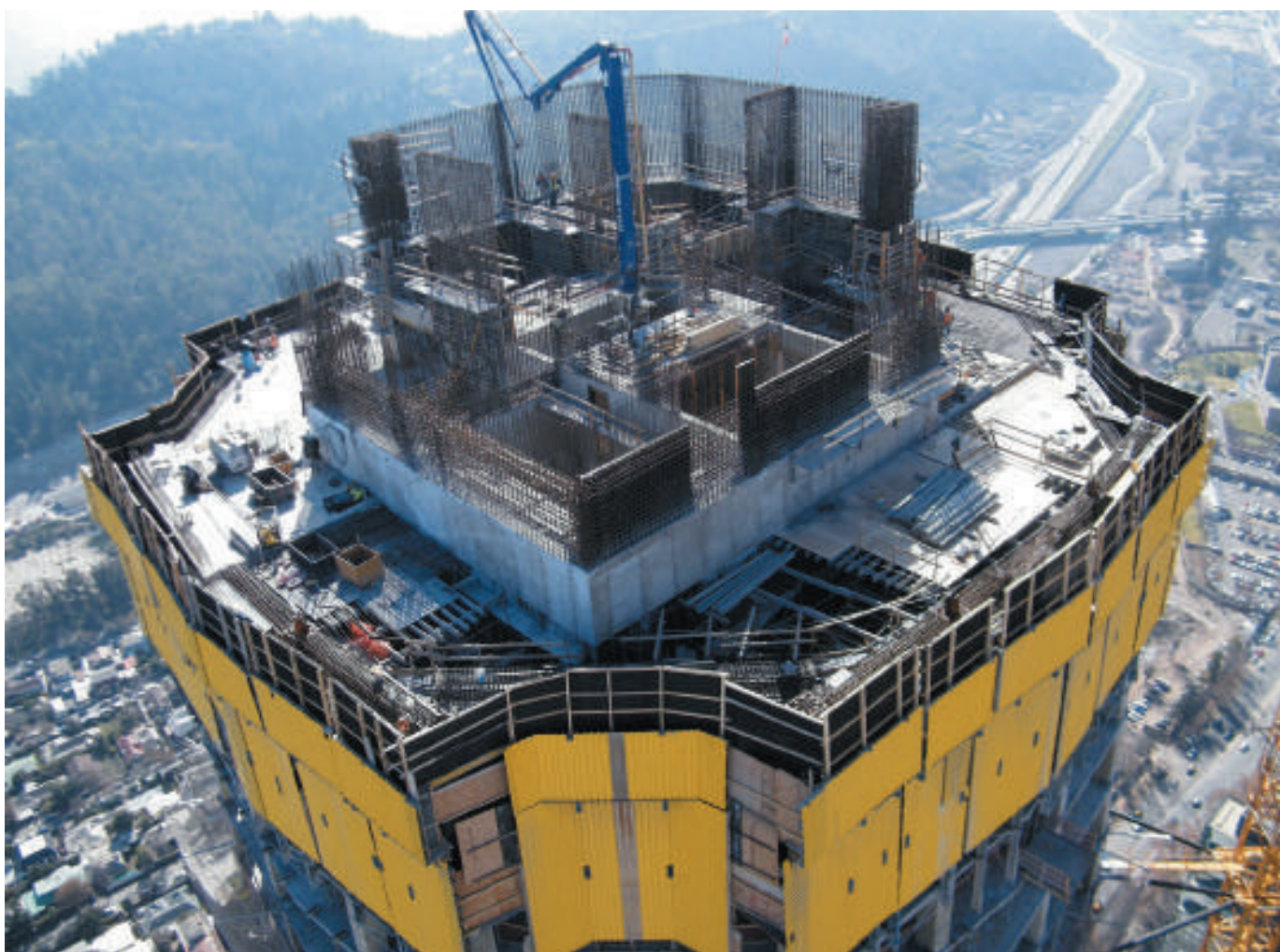
Fase de construcción del proyecto Costanera Center, que con 4 torres de edificios, es uno de los centros de negocios más importante de la capital de Chile. El proyecto albergará un hotel de 5 estrellas, oficinas, centros comerciales diurnos y una gran torre central, que se constituye en la estructura más alta de Latinoamérica, con 300 m de altura.
