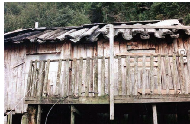
Figura 11: Casa con cubierta de "Canogas". Caleta Tortel, Undécima región de Aysén. Imagen del autor. 2000
