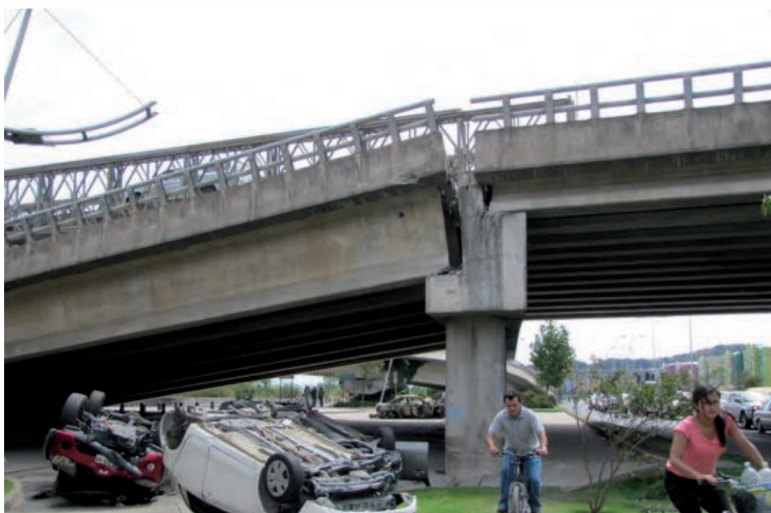
Puente Llacolén, el principal viaducto de la ciudad de Concepción hacia la provincia de Arauco, muestra los efectos del megaterremoto del 27 de febrero de 2010.
