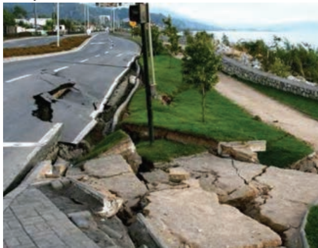
Fig. 12 Infraestructura vial afectada por agrietamientos y asentamientos (avda. Costanera Concepción)
