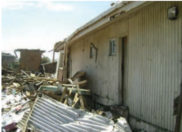
Fig. 31 Viviendas dañadas por el tsunami frente a la ribera del río Tirúa
