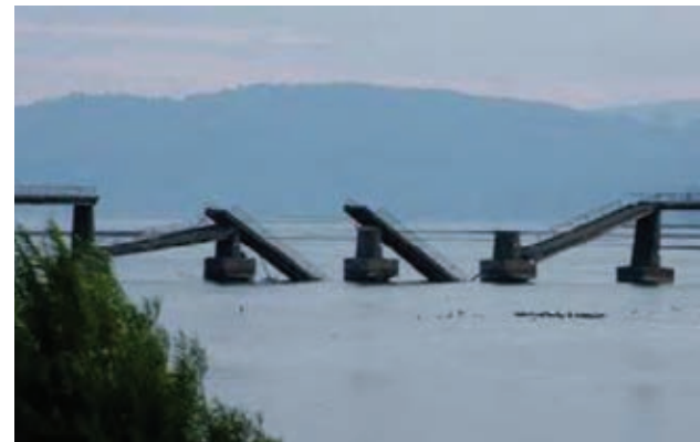
Fig. 4 Colapso total Puente Viejo
