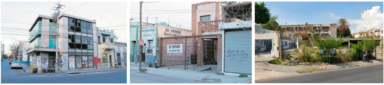
Figura 2. Abandono de la vivienda en CMM. Fuente: Elaboración de los autores con Google Earth Pro.
