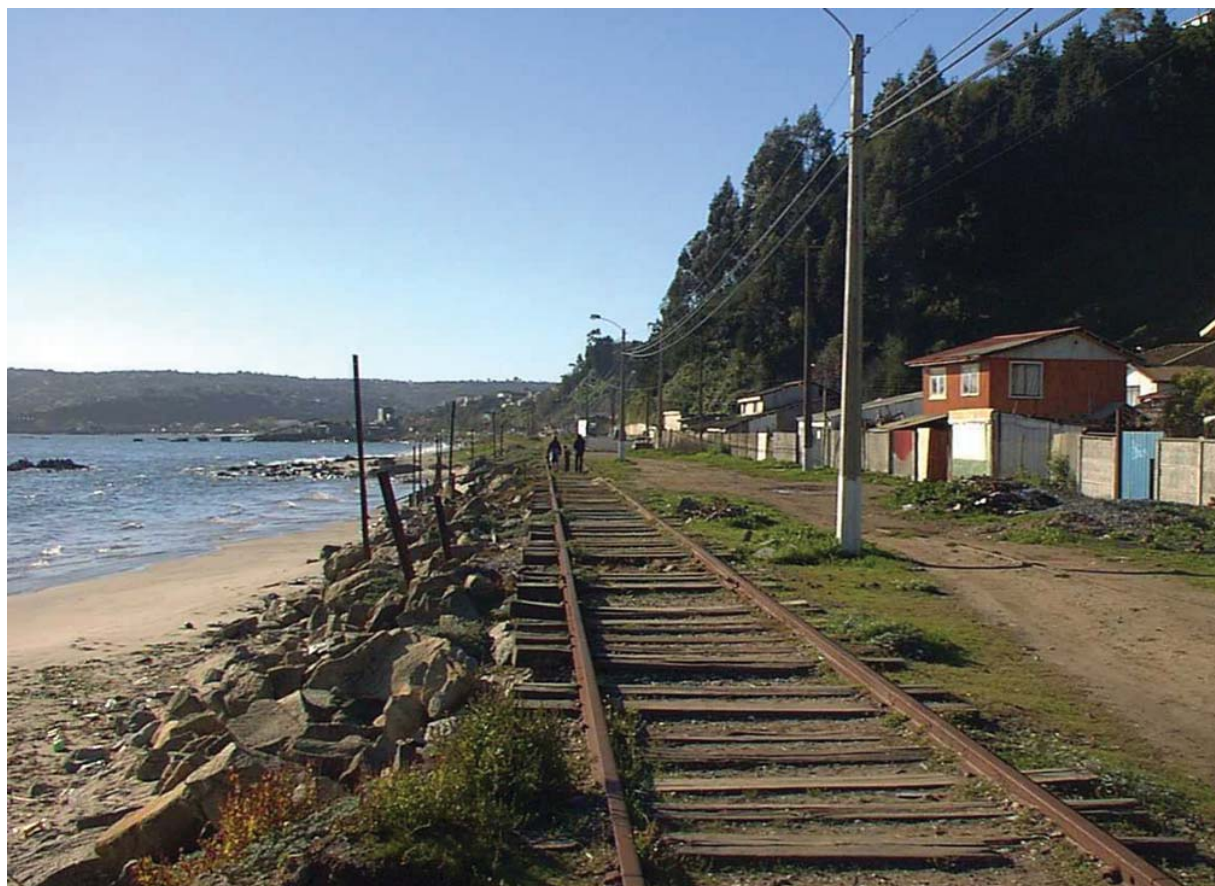
Línea férrea en deterioro, acceso a Tomé: sector en recuperación del borde costero.
