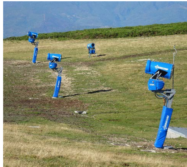
Figura 8. Cañones de nieve instalados en los años 2018 y 2019. Fuente: Foto de archivo de los autores (16/08/2019).
