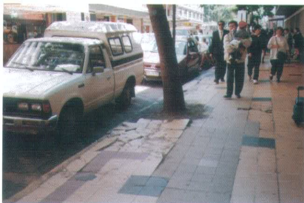
Raíces superficiales de árbol que afectan el pavimento urbano.
