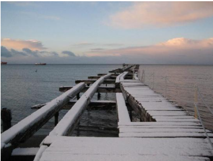
Imagen N° 18: Antiguo Muelle, patrimonio marítimo, ferroviario, cultural e ingenieril anclado en el fin del mundo. Fuente: gentileza Burgos M., 2007.
