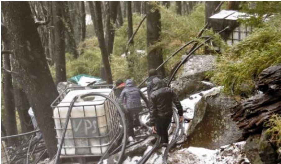
Fotografía 4: Mangueras para el abastecimiento de agua sector Las Trancas Fuente: La Discusión, 29/05/2019
