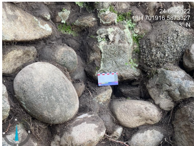
Figura 5. Detalle de las piedras que conforman la estructura y la matriz limo-arenosa observada entre ellas.
